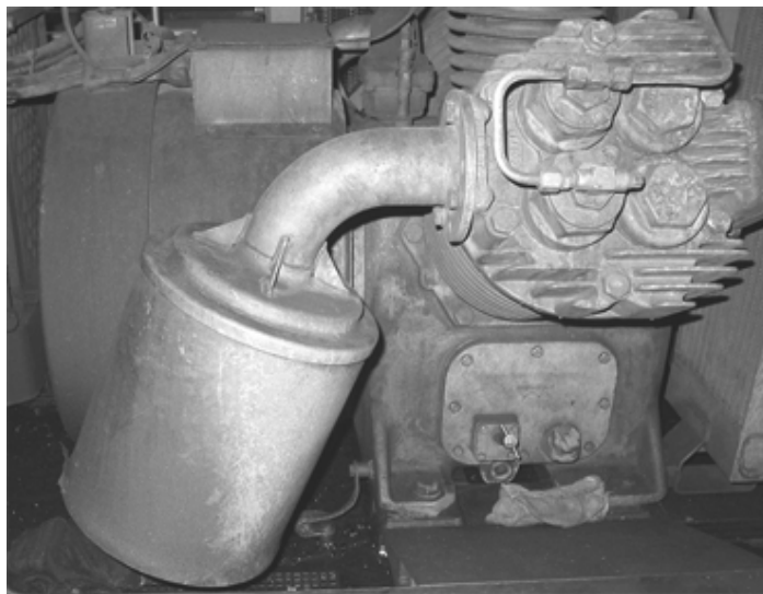
Abbildung 27: Luftfilter am Kompressor ohne Schalldämpfer
