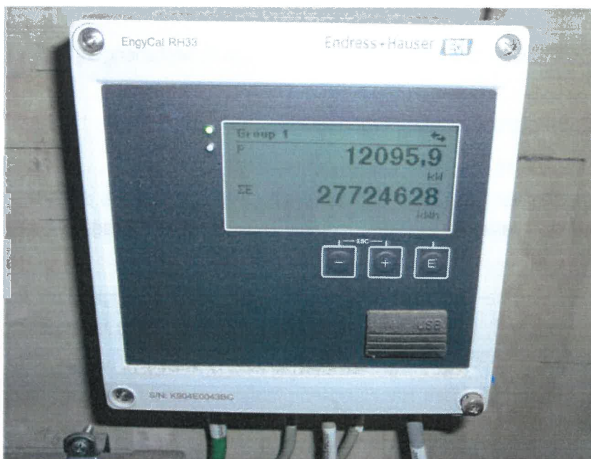
Abbildung 2-7: EngyCal RH33 Wärmehzähler für OSB-Vortrocknung
