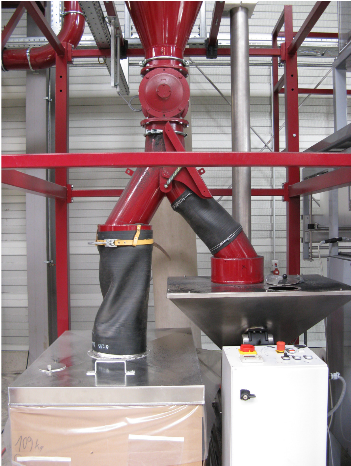
Bild 9: Beschickung der Dosieranlage
