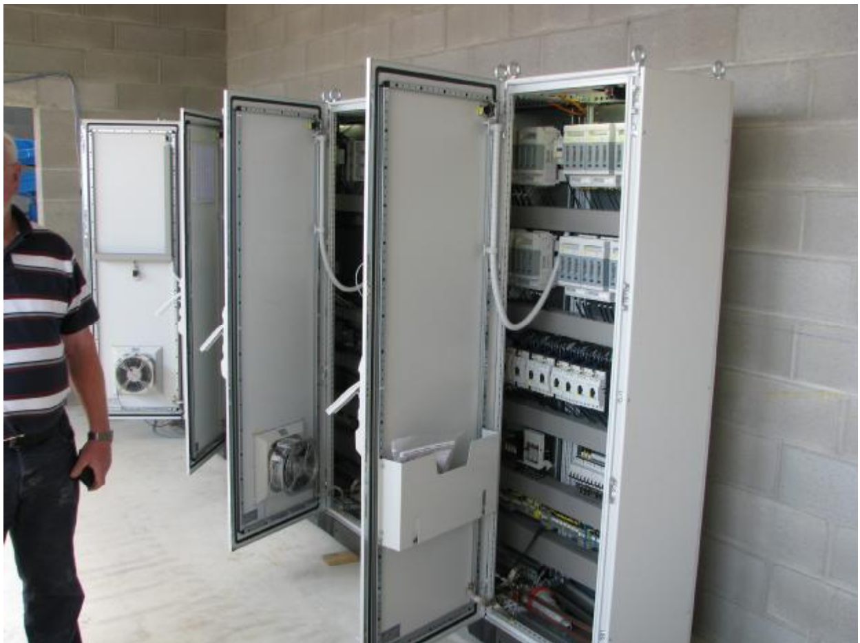
Abbildung 14) Zentraler Steuerschaltschrank der HV-Anlage
