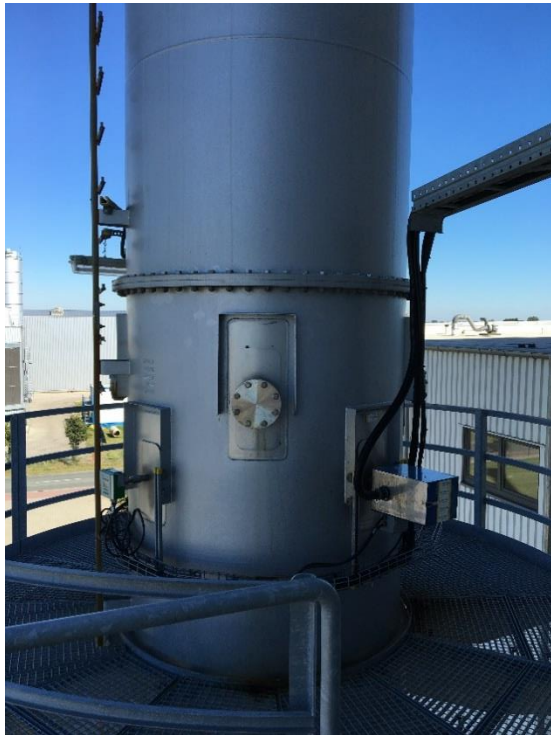
Abbildung 14 - Foto Entnahmestelle Abgaskamin
