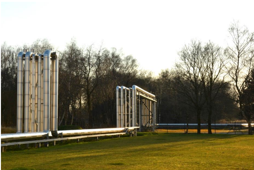
Abbildung 3 – Foto Trasse Prozessdampf und Prozesswärme
