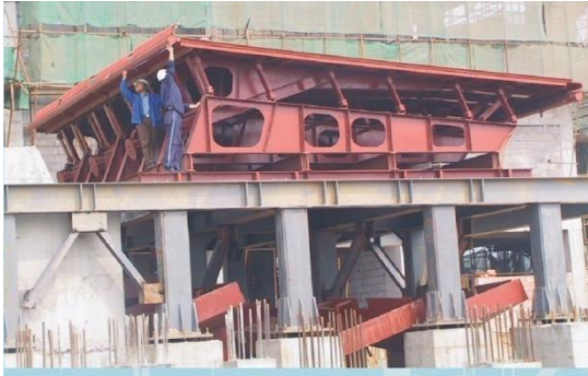
Abbildung 11 - Foto wassergekühltes Vibrationsrost
