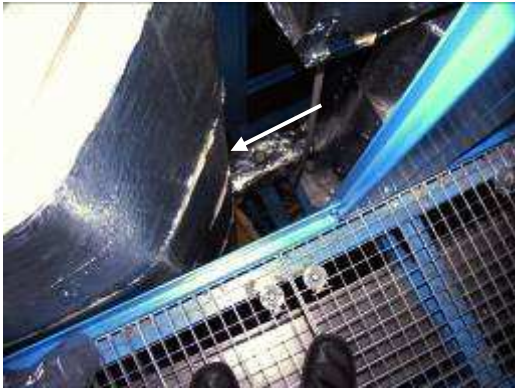
Luftkanal vom Heizmantel des Recyclingverdunsteters in den Verdunsterraum des Verdunsteters
