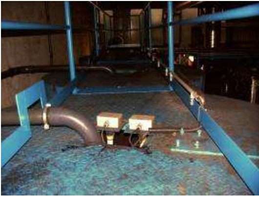
Tankanlage, Zulauf des Farbwaschwassers aus der Produktion
