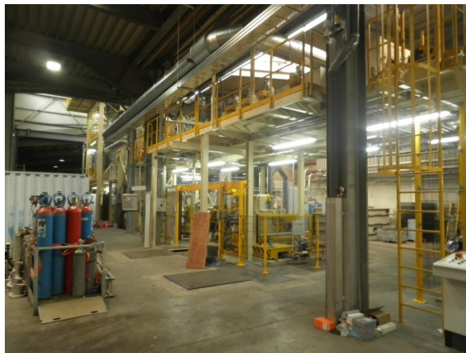
Abbildung 20: Abwickelvorrichtung/oben Rohr zur Abgaswärmerückführung
