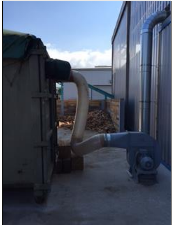
Abb. 29: Außenansicht auf den Späneabsaugventilator mit Containerverbindung
