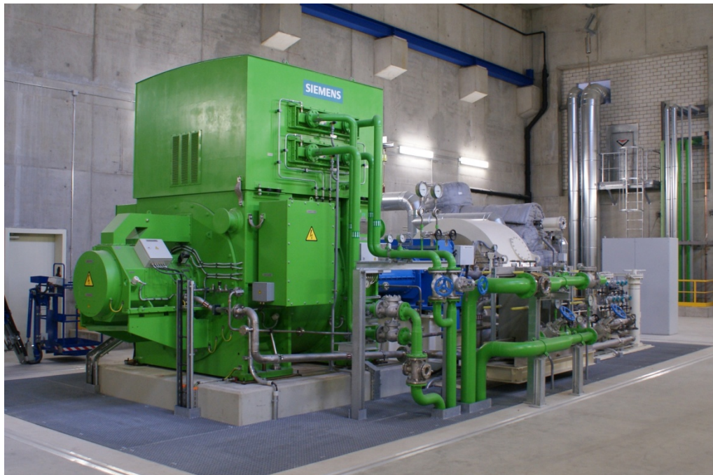
Abbildung 2-6: Turbine und Generator des Abhitzekraftwerks.
