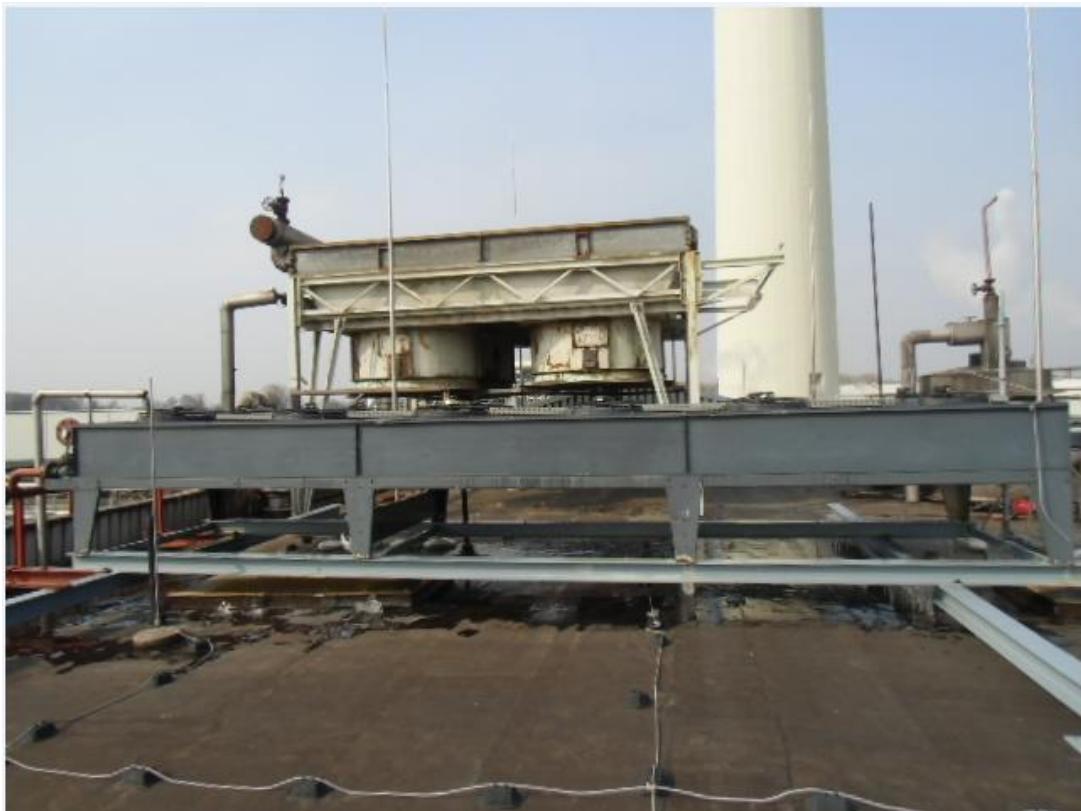
Abb. 8: alter Wärmetauscher im Hintergrund, zusätzlich installierter im Vordergrund [Quelle: Akzo Nobel Functional Chemicals GmbH]
