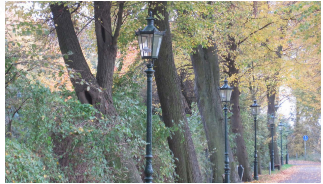
Mit neuen LED-Modulen ausgerüstete Beleuchtungsanlage | Quelle: Stadt Düsseldorf
