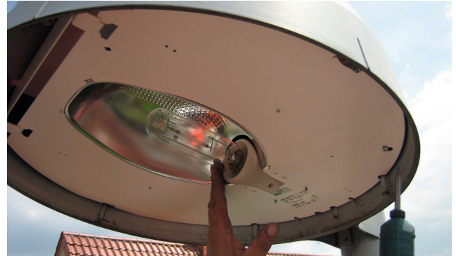
Leuchtenkopf nach dem Umbau mit nur einer energieeffizienten Lampe Quelle: RWE
