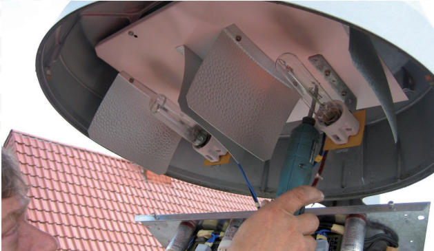
Leuchtenkopf mit alten Lampen vor der Umrüstung | Quelle: RWE
