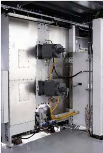
Abbildung 4: Antriebsmotoren der Prototypenanlage
