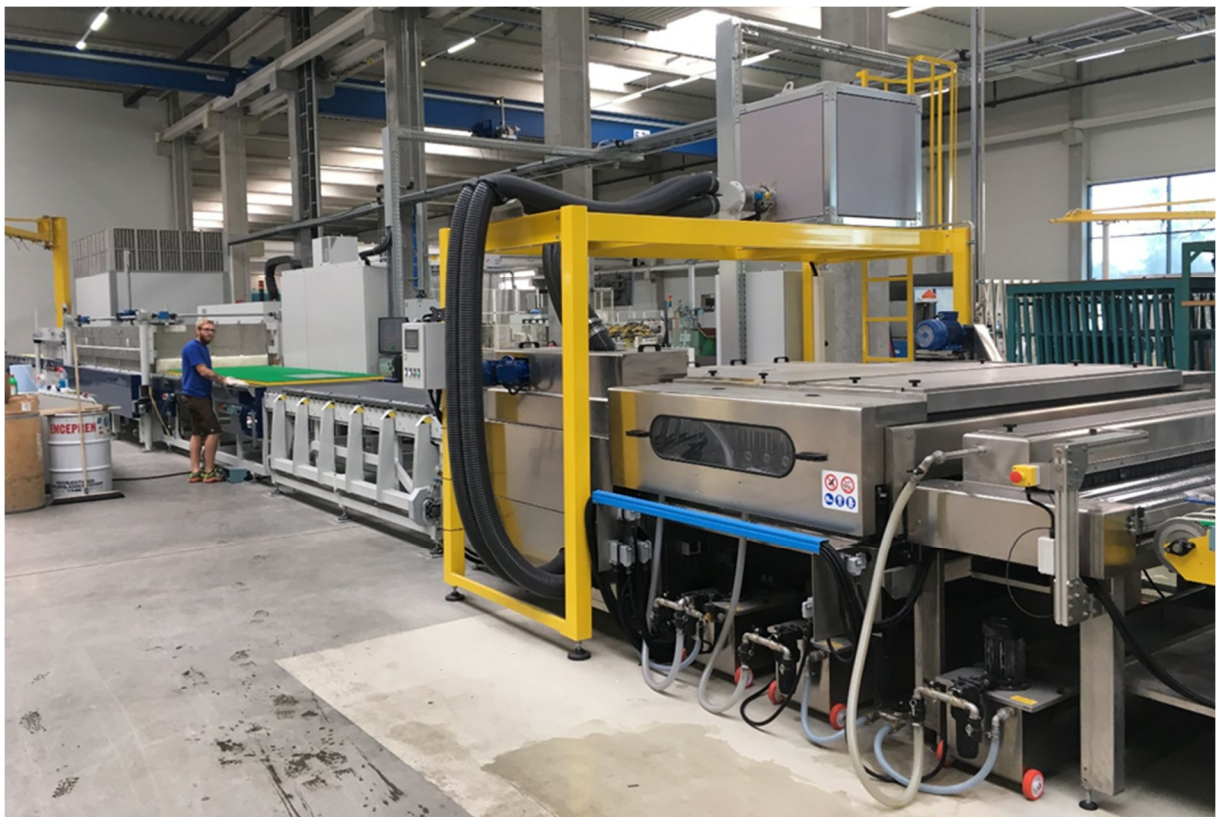
Abbildung 8: Float plus -Anlage nach der Inbetriebnahme
