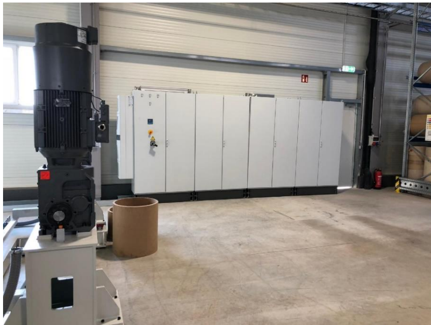
Abbildung 9: Schaltschrank der Anlage. Quelle: PECTEC GmbH
