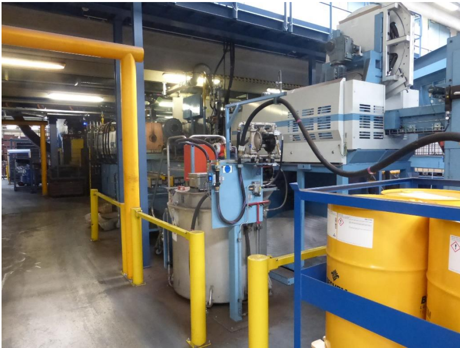
Bild 15: Induktionsanlage mit Zuführung
