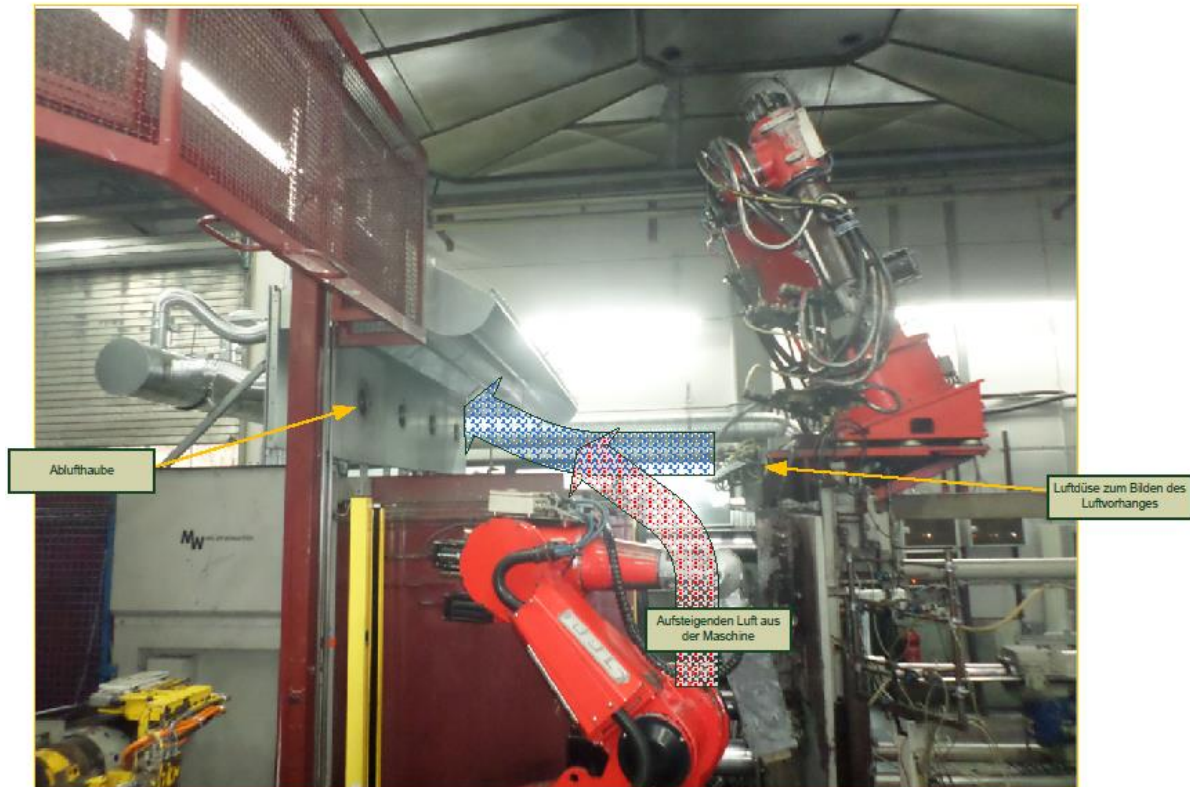
Abbildung 8: Realisierte Ablufferfassung mit Darstellung der Luftführung.
