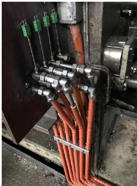
Abbildung 18: An Rohrleitungen installierte Thermosensoren
