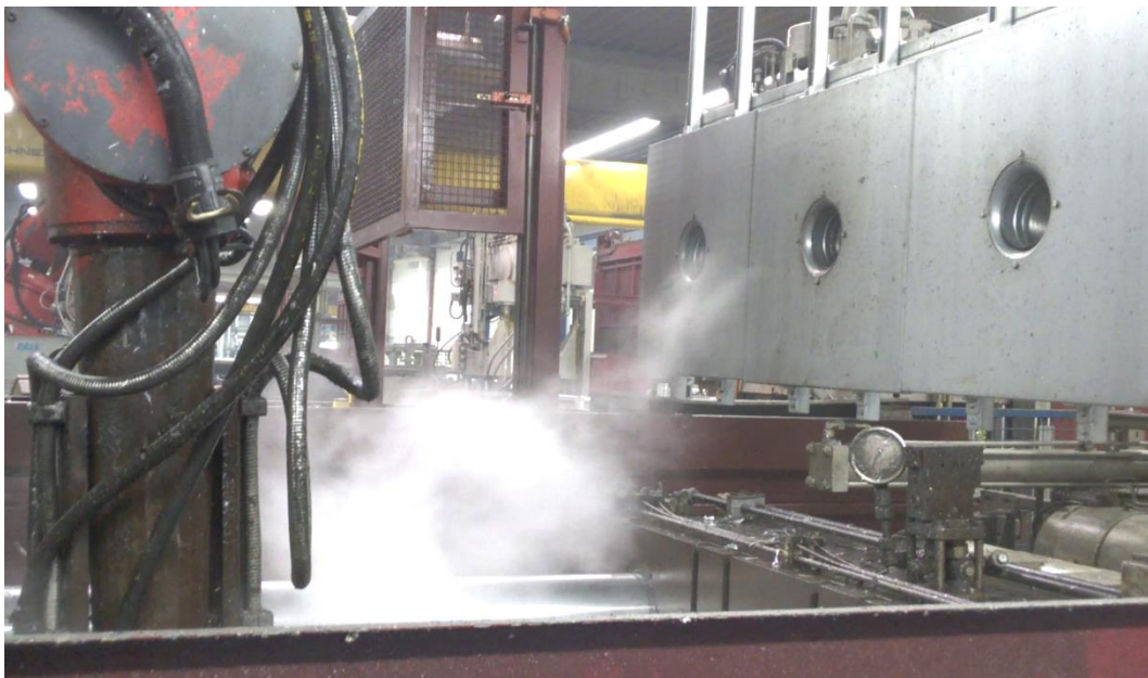
Abbildung 7: Teil der horizontalen Emissionserfassungs-Anlage an einer Gießmaschine
