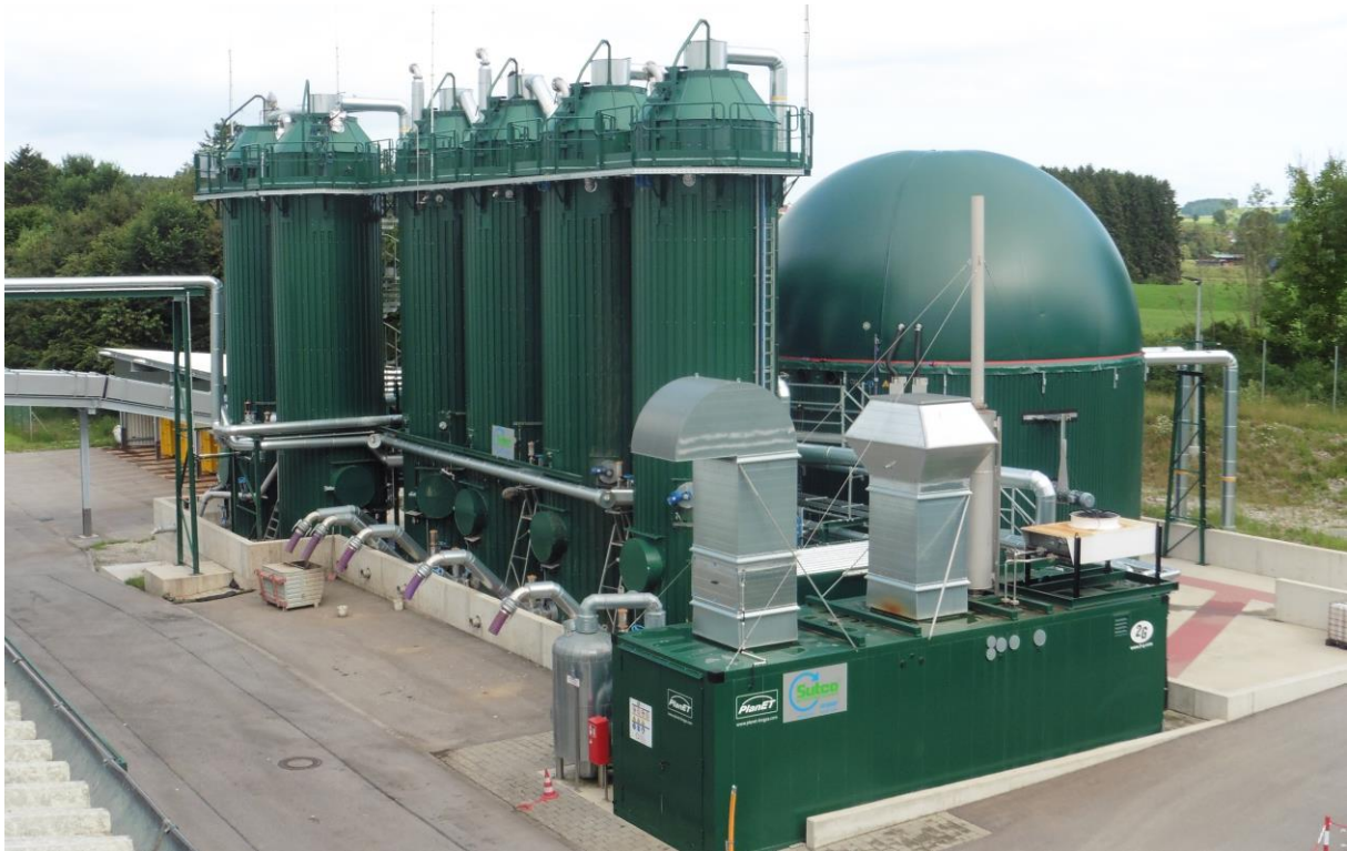
Abb. 7: Vergärungsanlage in Erbenschwang mit Vorlagebehälter, 2 Festbettfermenter, 2 Nachfermentern und dem nachgeschalteten Rührkesselfermenter (rechts)
