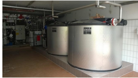
Abbildung 10: Kälteanlage-Zentrale mit Absorber und Eisspeicher
