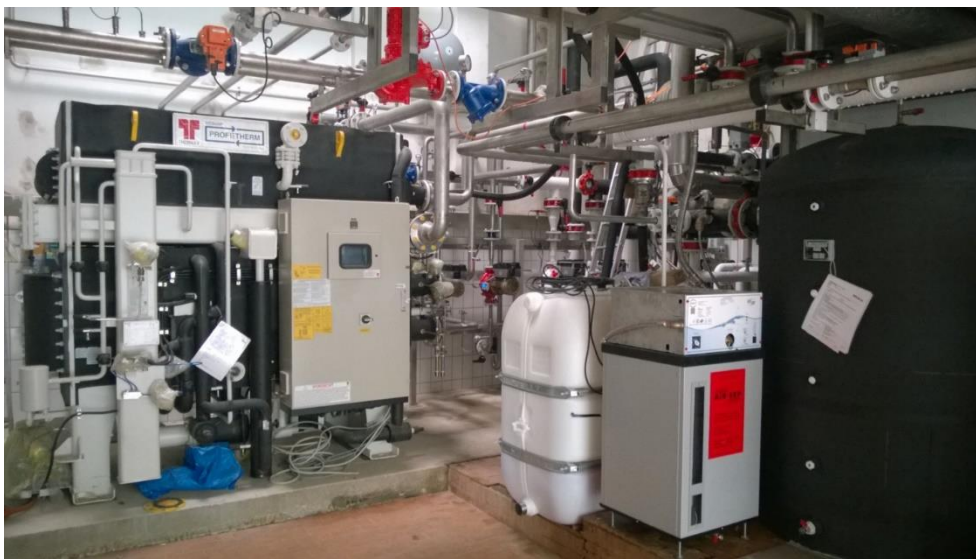
Abbildung 11: Kälteanlage-Zentrale mit Absorber, Pumpenstation und Glykol-Nachspeisung
