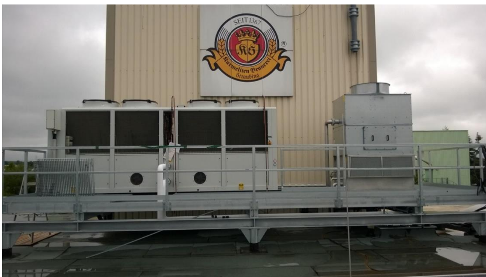
Abbildung 12: Propankälteanlage und Absorber-Kühlturm (auf Dach)
