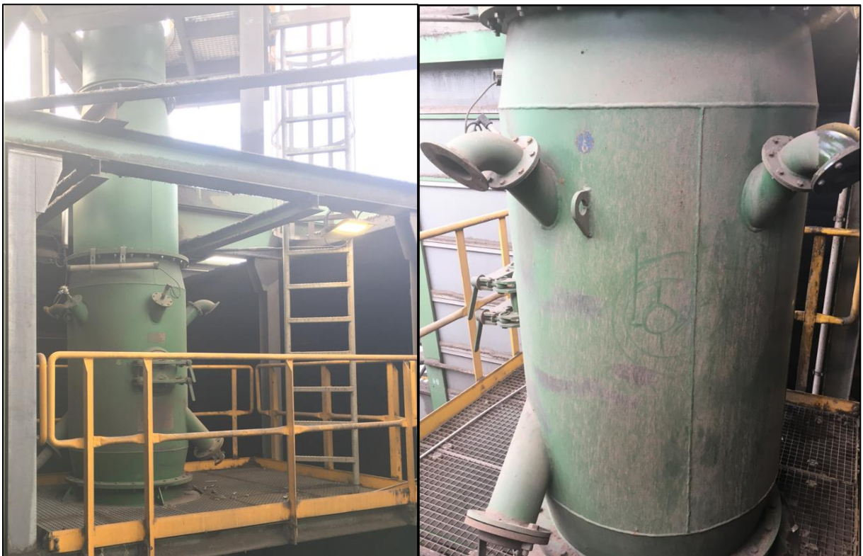
Abbildung 11: Mischring im eingebauten Zustand
