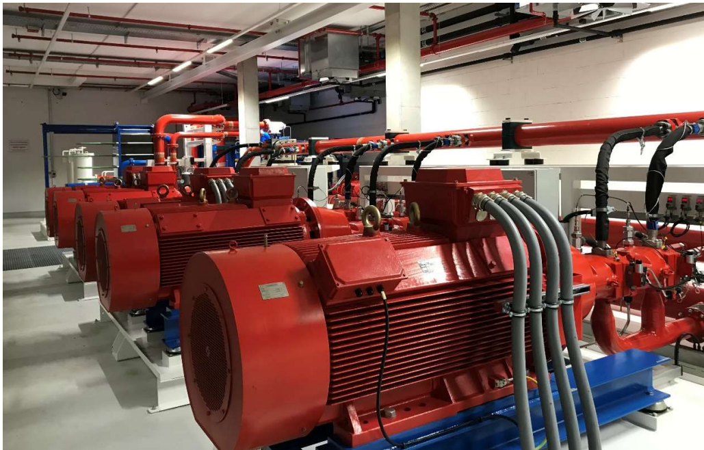
Abb. 2: Fertig montierte Hydraulikanlage im Testzentrum (nicht Bestandteil der Förderung)
