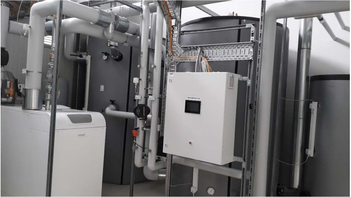
Abbildung 18 - Warmwasserspeicher, Foto Gelinova
