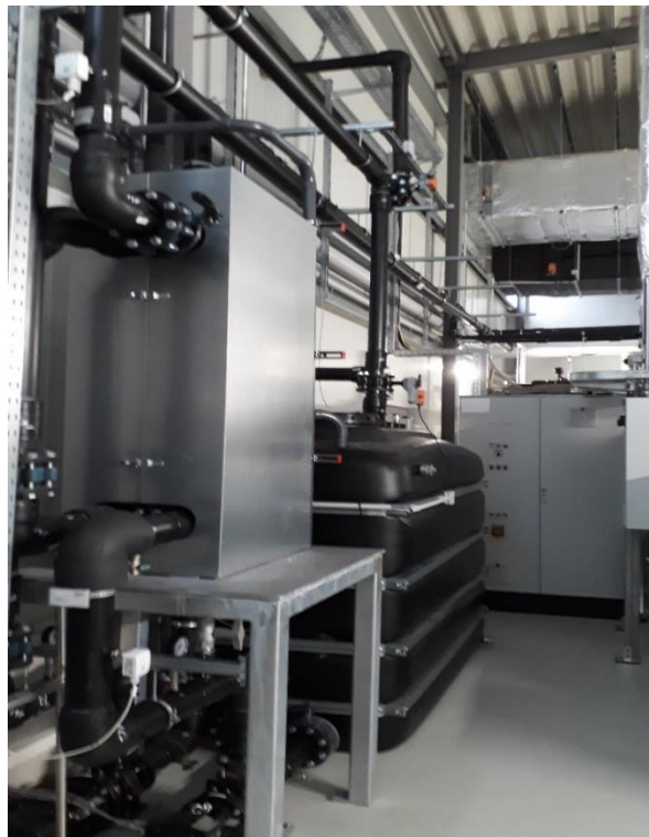
Abbildung 16 - Luftaufbereitungsanlage (teilweise) und Puffertank Wasserrückkühlanlage mit Wärmetauscher, Foto Gelinova
